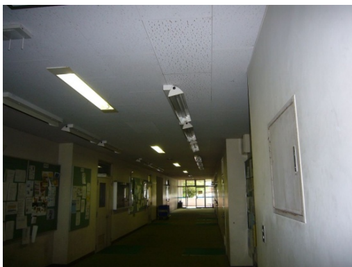
A棟 1階廊下 掲示板照明消灯（不用事消灯している）
