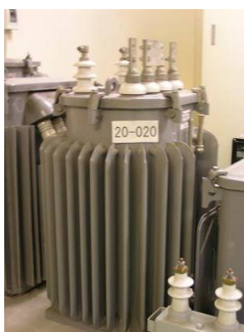
保管中のトランス
