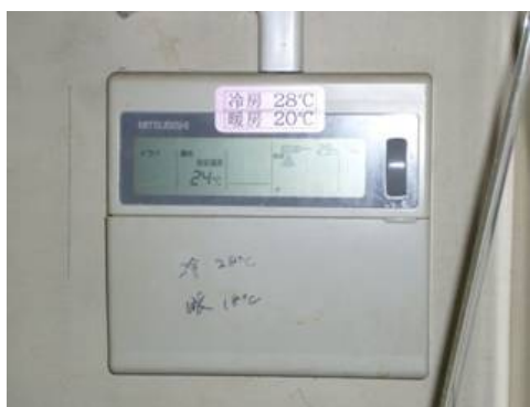
B棟 資料室 設定温度 24°C 目標設定温度が表示されているが守られていない
