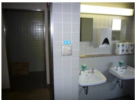
B棟 男子トイレ 誰も居ないのに照明点けっ放し
