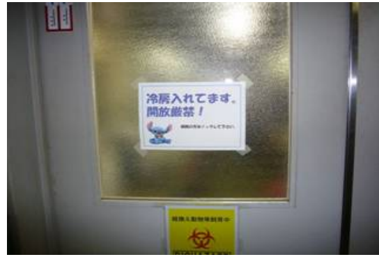
B棟 化学実験室 エアコン冷房運転中は入口ドア解放厳禁表示し、ドアを閉めていた。
