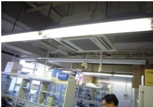
A棟 標本作成実験室 不要な照明は部分消灯
