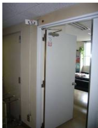
A棟 資料室 エアコン冷房運転中に入ロドアが解放していた。 冷房中はドアを閉めましょう。
