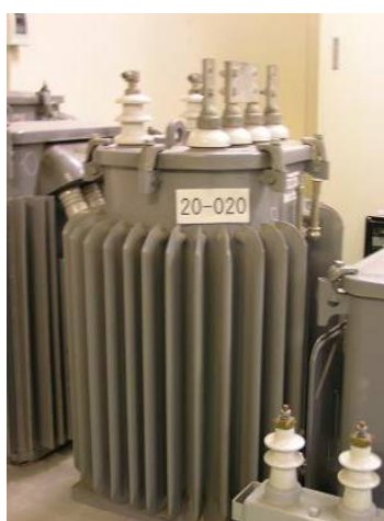
保管中の微量混入トランス(朝倉団地)
