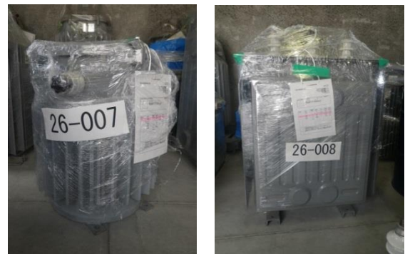
保管中の微量混入トランス（朝倉）
