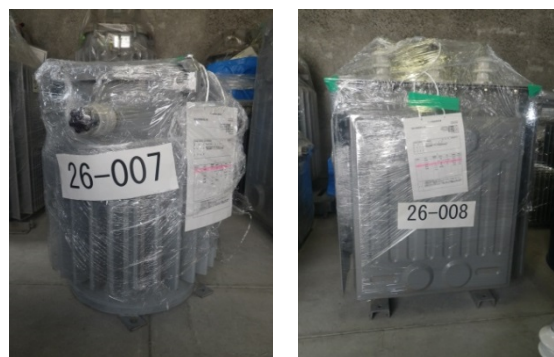
保管中の微量混入トランス（朝倉）
